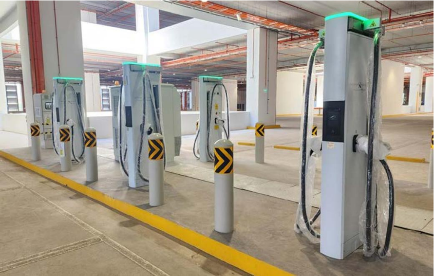
Figura 3.31: Cargadores en Sengkang West
